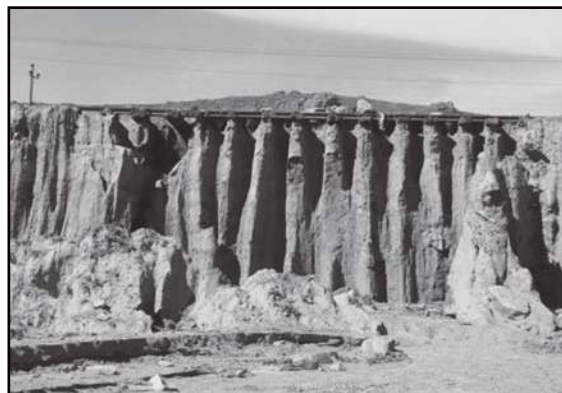
■ Terraplén de las vías del ferrocarril totalmente erosionado, en proximidades de Comallo.
