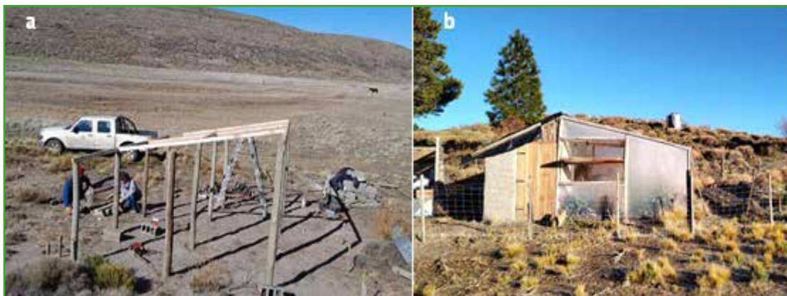
Figura 1: Proceso de construcción del invernadero con cámara. (a) Armado con estructura de madera. (b) Invernadero con polietileno y cámara de quincha con puerta de entrada.
